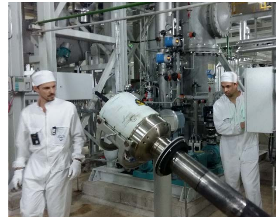
Torche à plasma - installation KNPP
