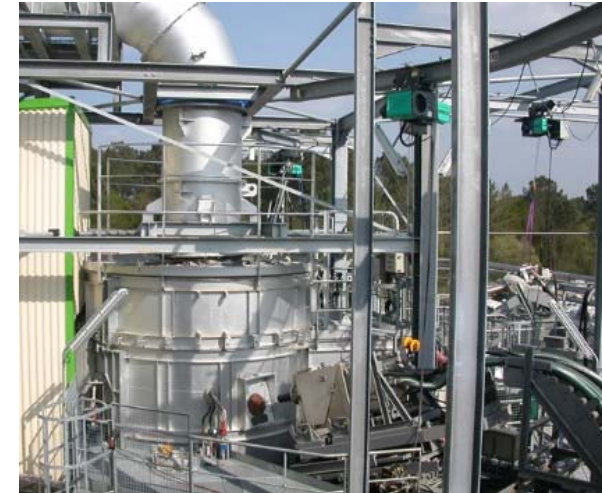
Four de vitrification d'amiante - Inertam
